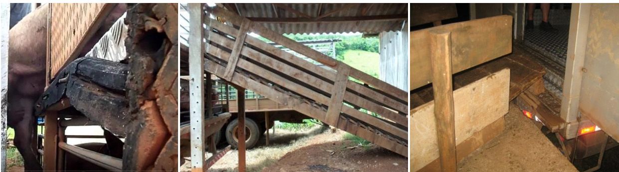
Figura 1. Instalações inadequadas que podem comprometer o bem-estar dos manejadores e dos suínos.
