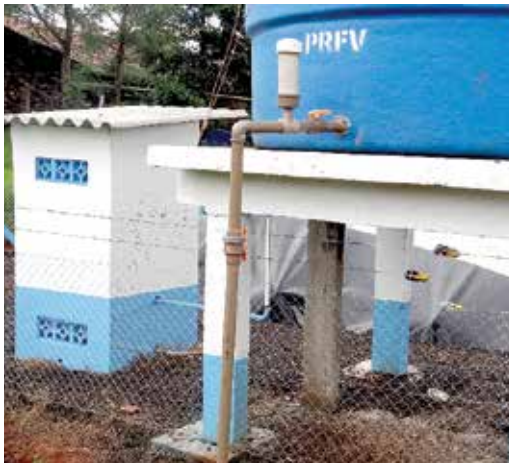
FIGURA 06 | Caixa d'água com clorador acoplado
