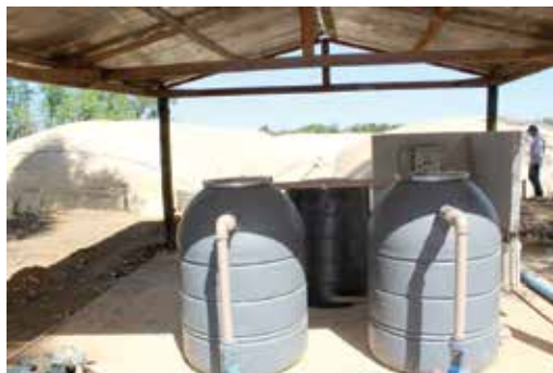
FIGURA 29 | Conjunto de filtros utilizados para reduzir a concentração de gás sulfídrico (H 2 S)
