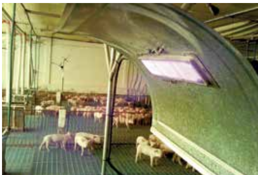
FIGURA 31 | Uso da energia térmica do biogás para o aquecimento de suínos.
