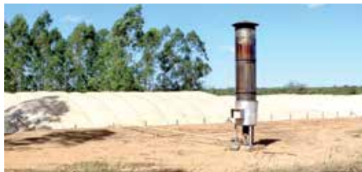
FIGURA 28 | Biodigestores acoplados ao queimador de biogás (flare)
