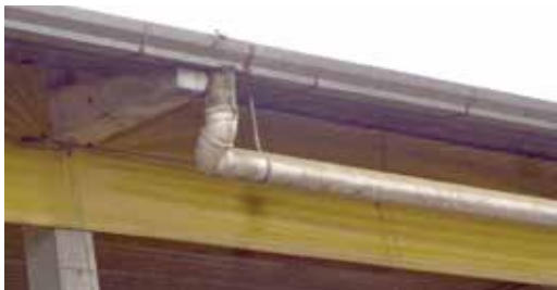
FIGURA 02 | Calhas de captação da água chuva do telhado da granja
