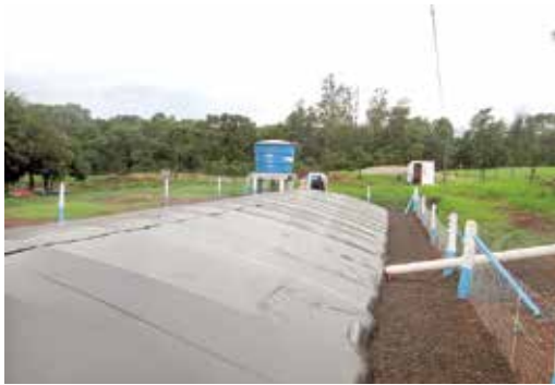
FIGURA 05 | Cisterna de armazenagem de água da chuva e caixa de água
