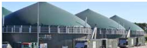
FOTO 48 | Reatores de Mistura Contínua
