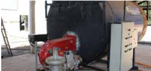
FOTO 29 | Caldeira com aquecimento a biogás de uma fábrica de subprodutos de suínos e aves.
