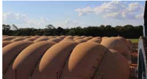
FOTO 13 | Uma série de biodigestores em pleno funcionamento.
