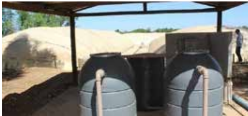
FOTO 24 | Sistema de filtragem do gás sulfídrico do biogás.
