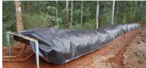
FOTO 26 | Balão pulmão com depósito de biogás, pré-gerador.
