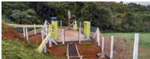
FOTO 25 | Sistema de regulação da pressão do biogás dentro do biodigestor que utiliza água como controle de nível e queimador (flare) do excedente do biogás.
